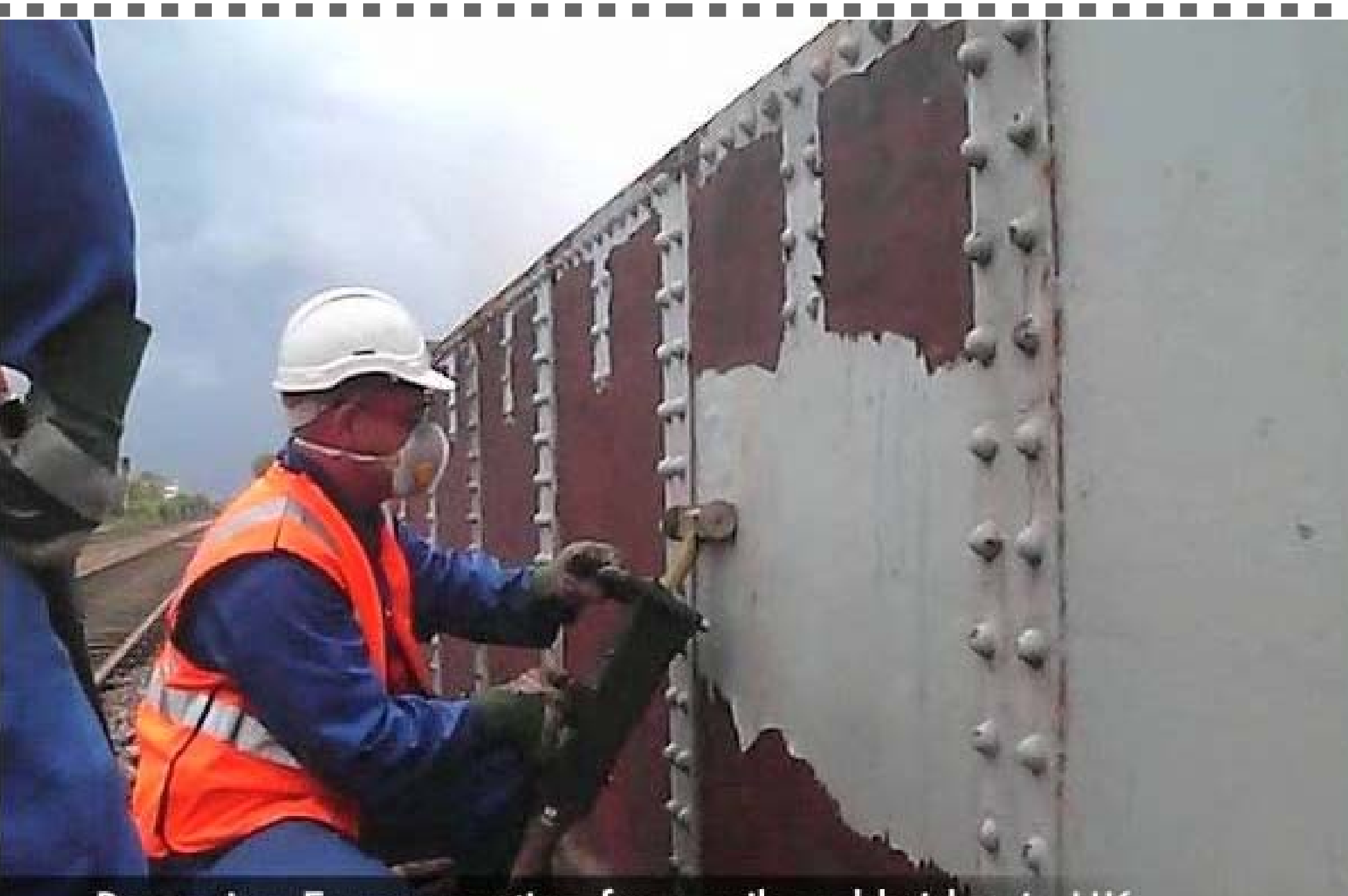
Epoxifärg ovanpå järnoxid-primer, 0,4-0,6 mm Järnvägsbro, Storbritannien, Juni 2007
